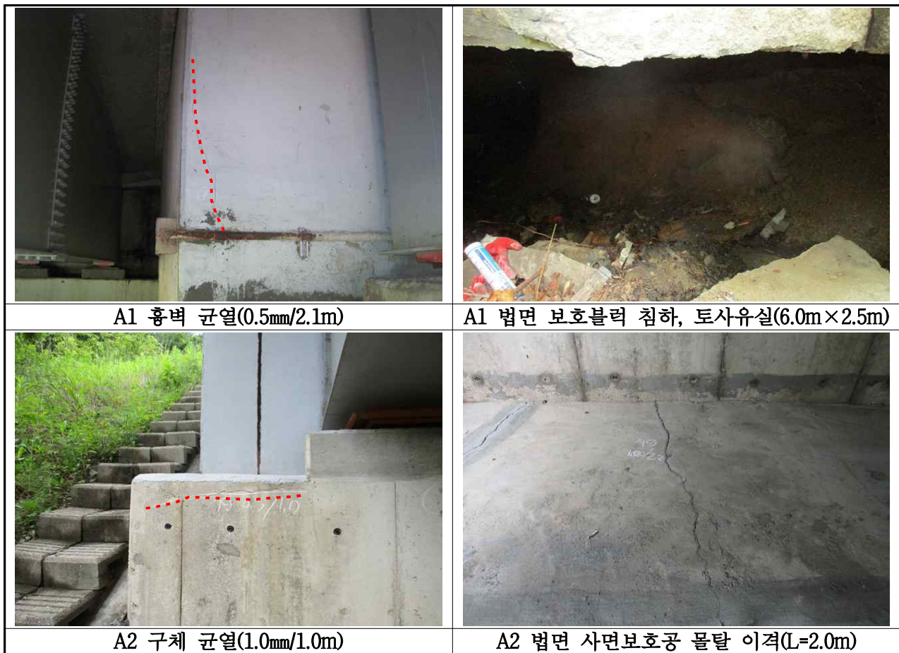
【사진 3.10】교대 손상현황
