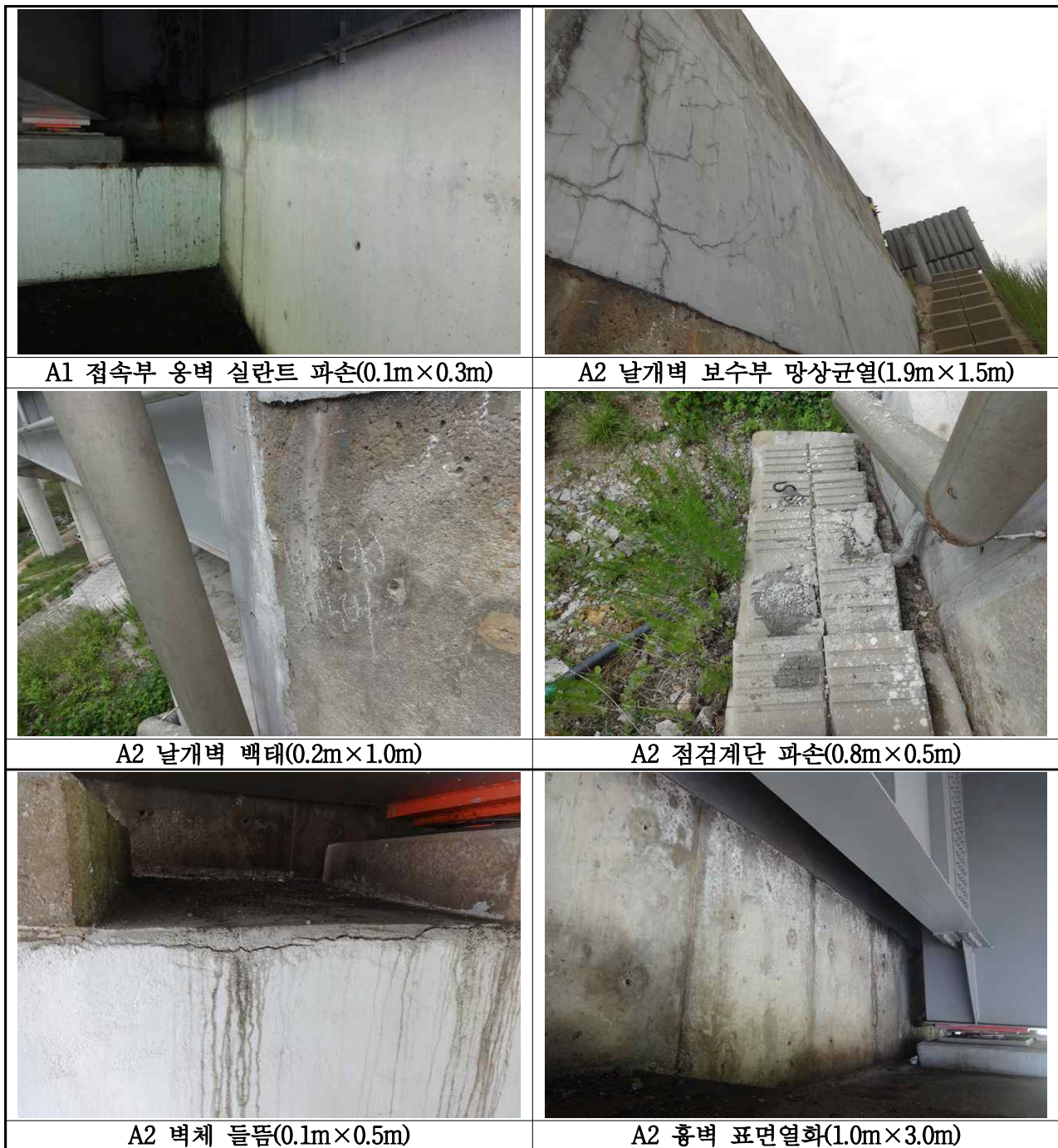
【사진 3.35】 교대 손상현황
