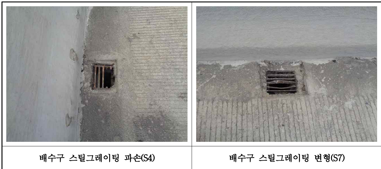
【사진 3.48】 배수시설 손상현황
