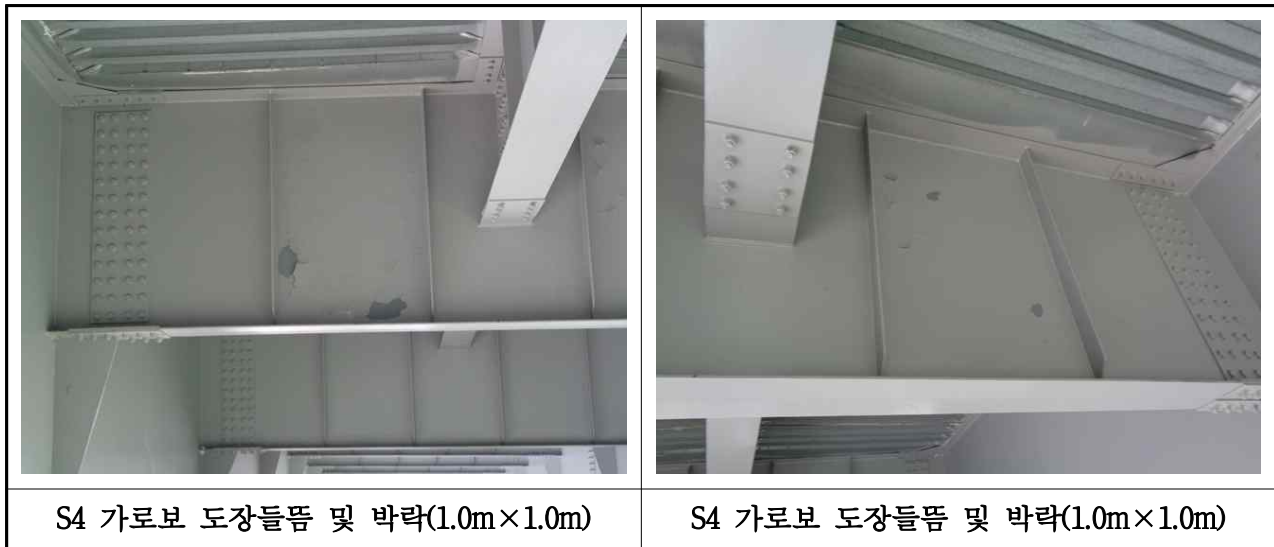
【사진 3.8】 가로보 및 세로보 손상현황
