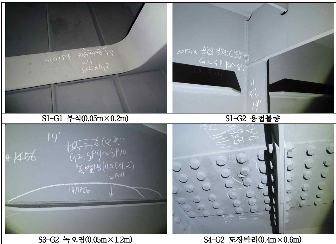
【사진 3.6】 거더 내부 손상현황
