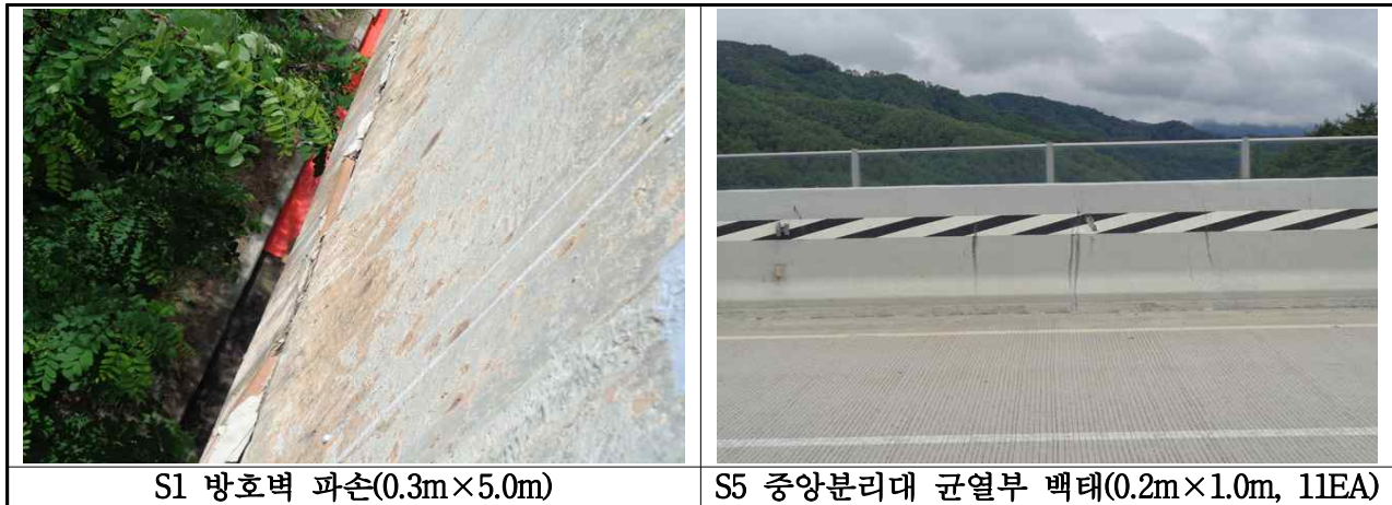
【사진 3.50】 방호벽 및 중앙분리대 손상현황
