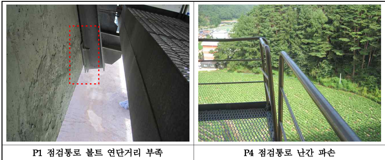
【사진 3.27】 교량 점검시설 손상현황
