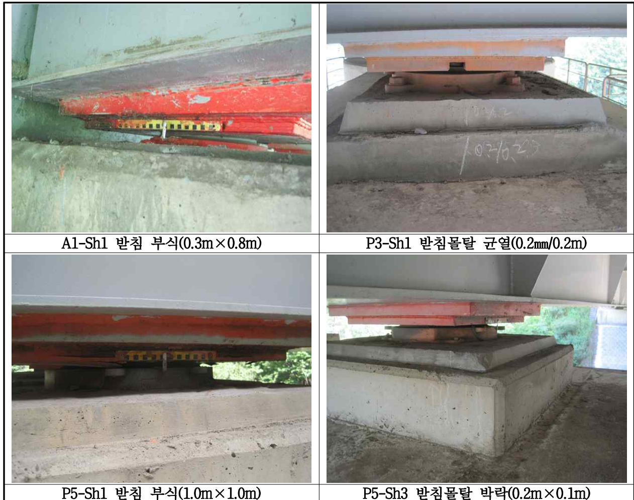
【사진 3.14】교량받침 손상현황
