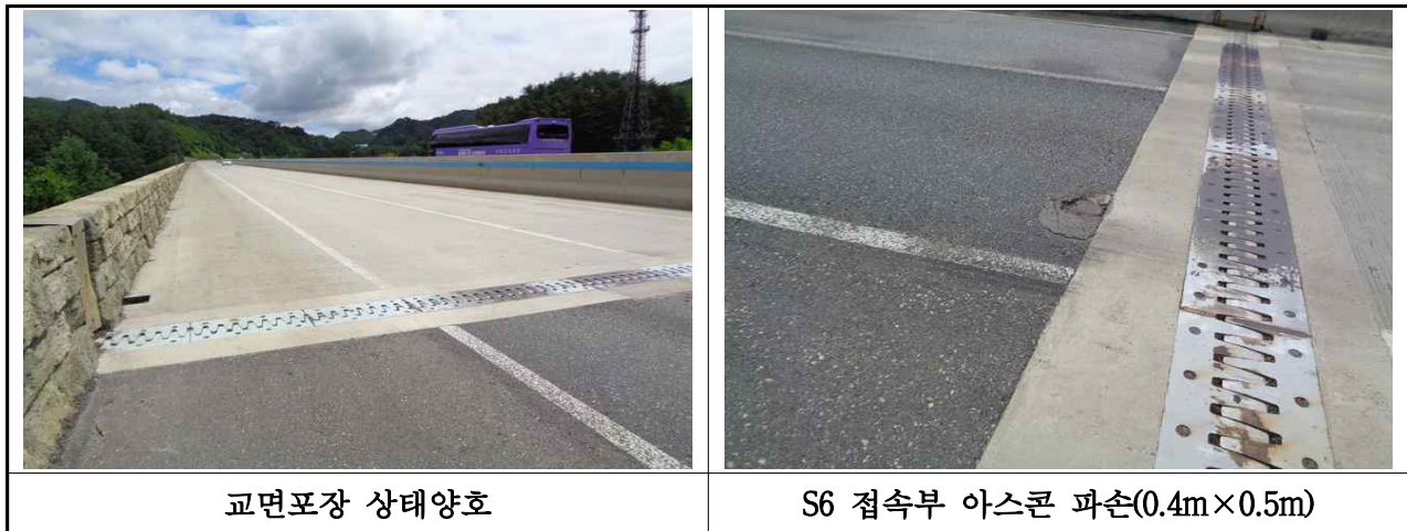
【사진 3.21】 교면포장 손상현황
