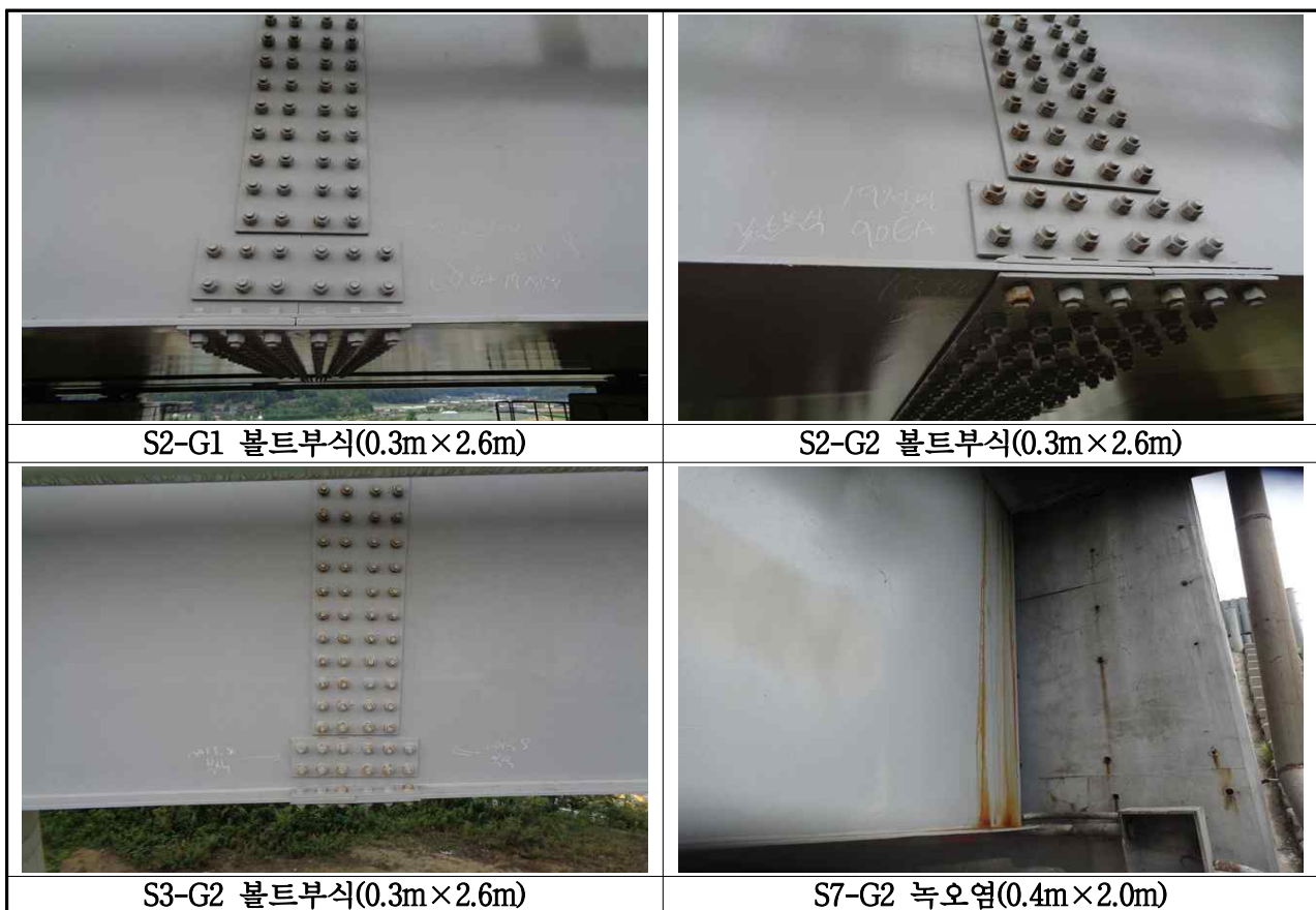
【사진 3.31】 거더 외부 손상현황
