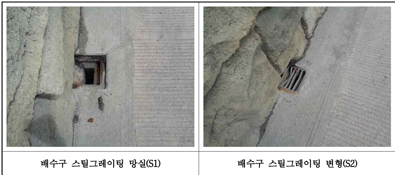
【사진 3.23】 배수시설 손상현황
