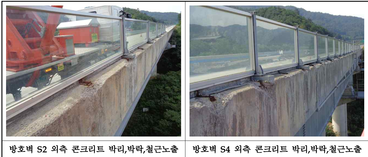
【사진 3.25】 방호벽 및 중앙분리대 손상현황
